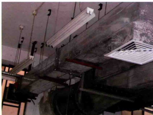
图4-5 空调送风系统
